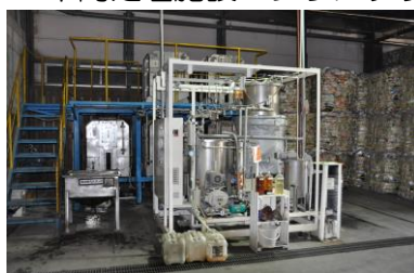
廃油燃料（BDF）製造装置
